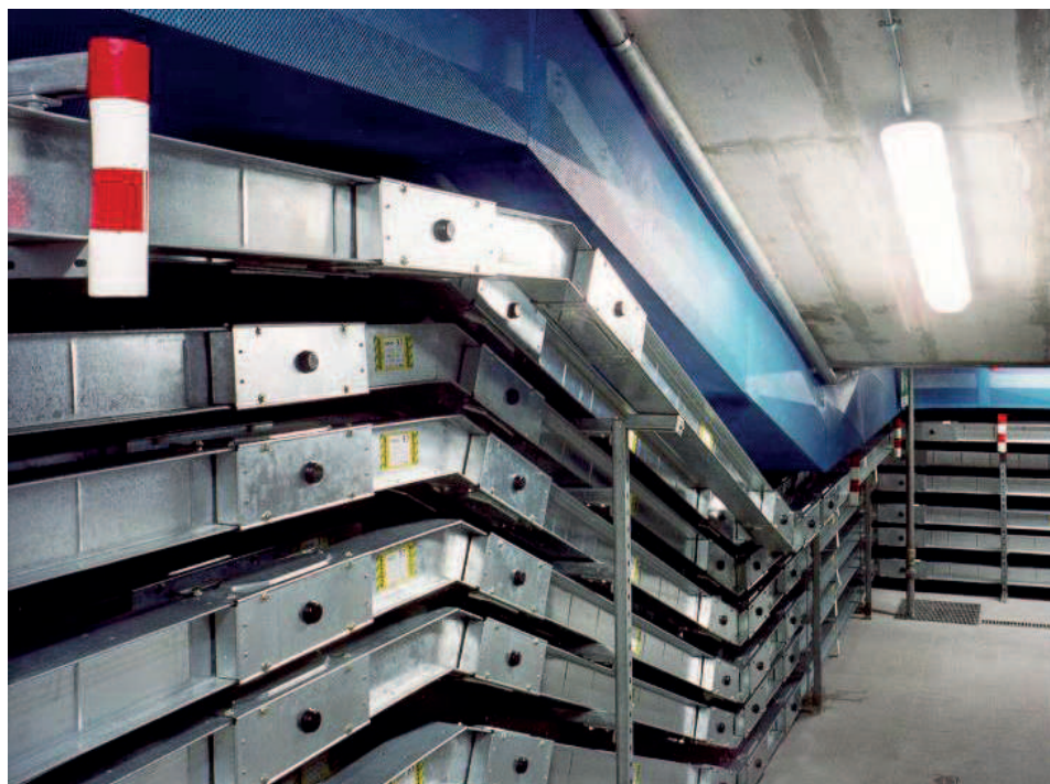
Przykład instalacji rozdzielczej dużej mocy
