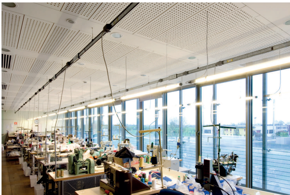
Przykład instalacji oświetleniowej i rozdzielczej małej mocy realizowanej za pomocą szynoprzewodów
