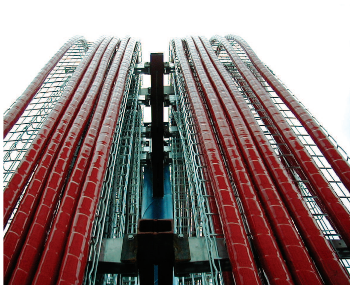
Przykład instalacji kabli w korytkach wymagających dużej przestrzeni
